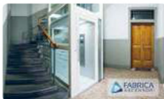
Impianto L. 13.89 in vano scala
